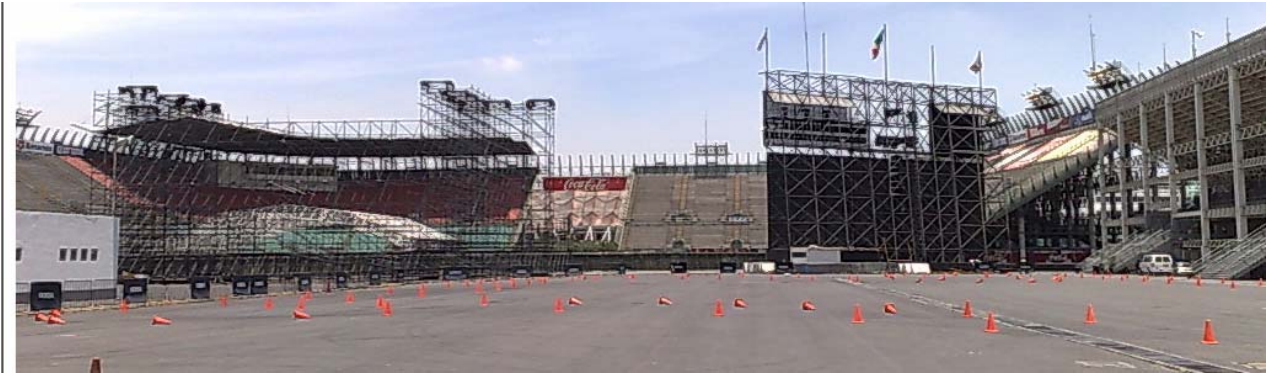
Figura 56.- Vista general del Foro sol desde la zona de pits, al fondo la cubierta para parque de béisbol, a la derecha las gradas construidas sobre pits y al frente el sistema marcador.
