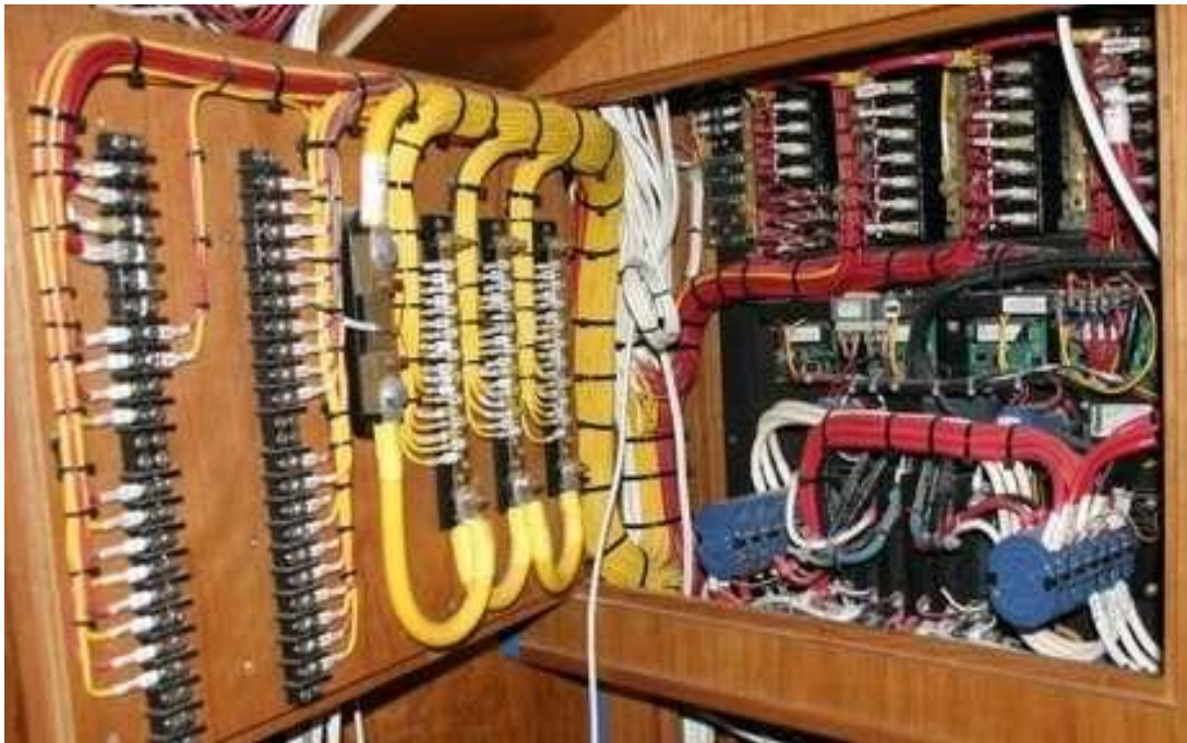
Figura 2.27 Panel de conexión del cableado eléctrico de un velero [25]
