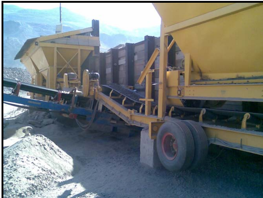
Fig. no. 10.- Tolvas dosificadoras de grava-arena y finos.
