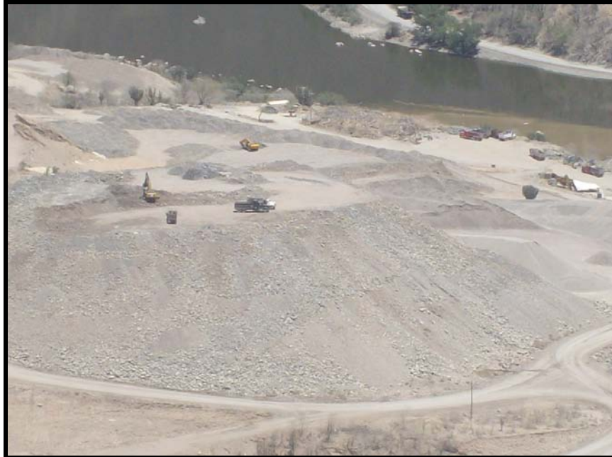
Fig. no. 15.- Almacén general de materiales procesados para cortina.
