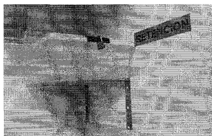
Figura 34- Contenedor de retención en cámara de almacenamiento.
