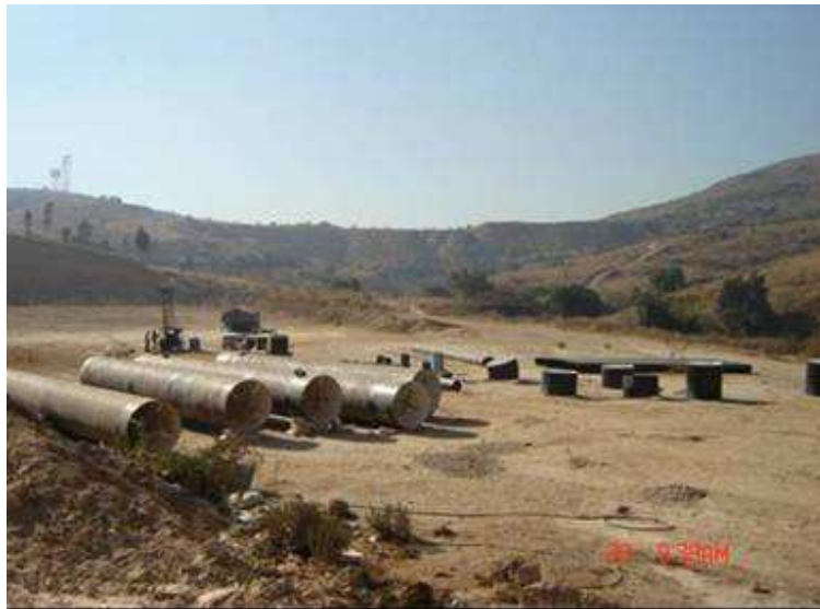
PANORAMICA DONDE SE OBSERVA LA UBICACIÓN DE LA MAQUINA PERFORADORA REALIZANDO EL SONDEO SPT - 1
