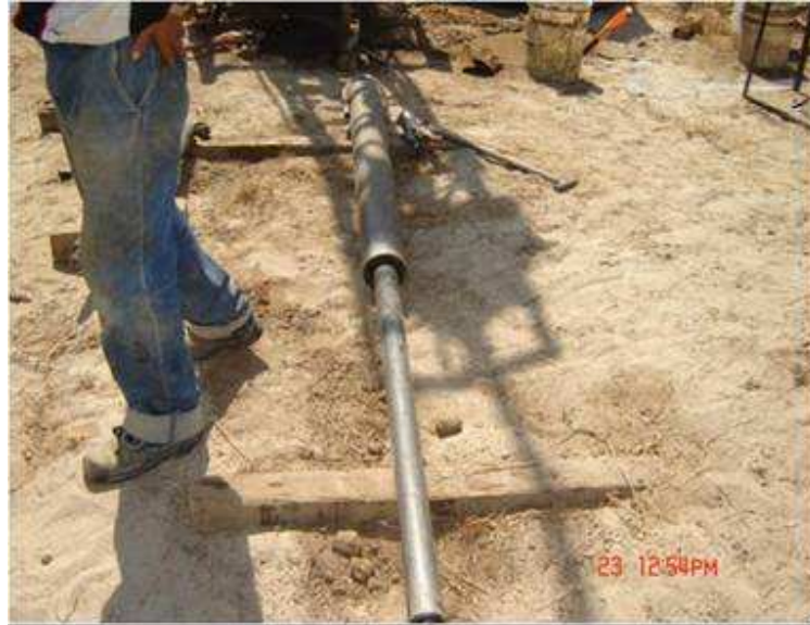
EQUIPO DE PERFORISTAS BAJANDO EL EQUIPO Y HERRAMINETA PARA LOS TRABAJOS DEL SONDEO NUMERO 1
