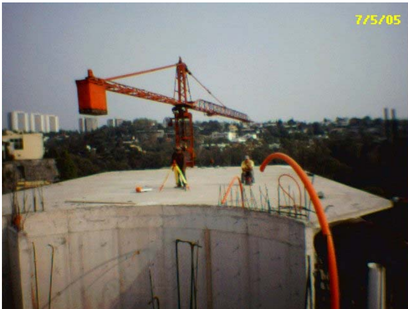
Fig. 38 Parte superior de torre grúa: brazo y contrapeso.
