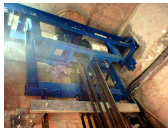
Fig. 84 Motor de elevador.
