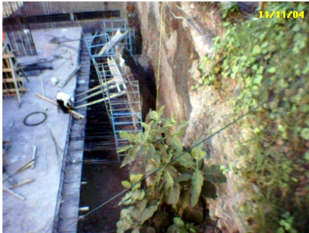
Fig. 140 a 142 Fractura de talud por reblandecimiento provocado por fuga de agua.
