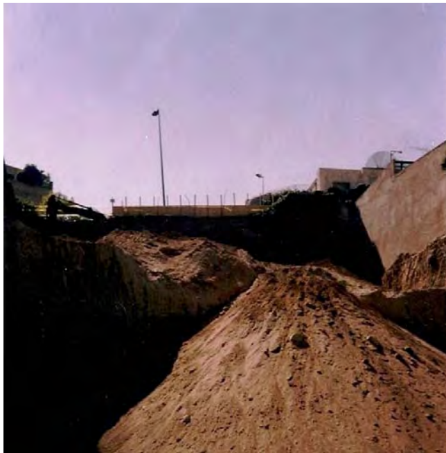
Fig.7 Material lanzado a zona baja del edificio.
