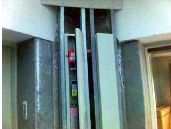
Fig. 85 Tablero de control exterior del elevador.
