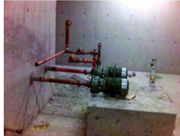
Fig. 80 Conexión de bombas de alimentación a tinacos.
