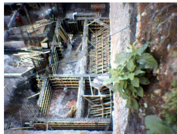
Fig. 33 Cimbra en cisterna. Nótese diferencia en el apuntalamiento de Un muro normal y un contramuro.
