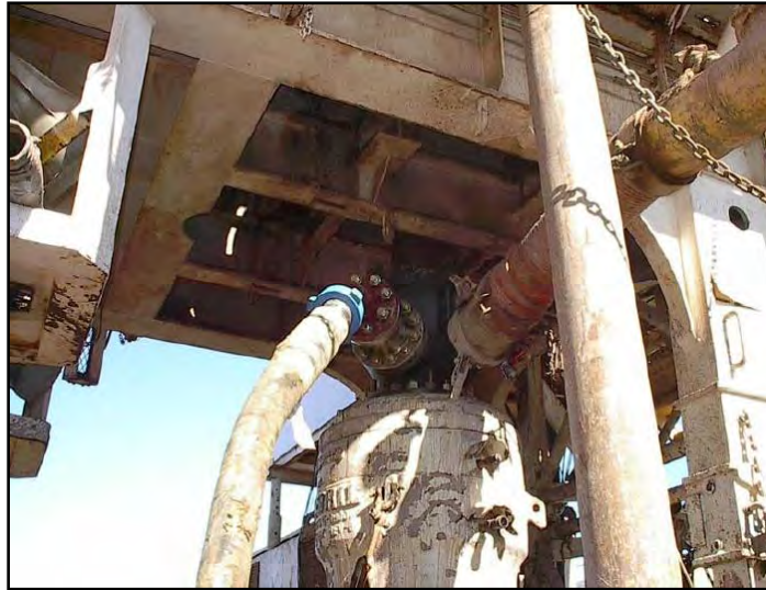
Figura 2.6 Dispositivo de Control Rotatorio, RCD, instalado en la cabeza del pozo, en la parte superior del preventor anular.
