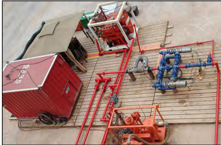
Figura 1.5 Equipo para MPD instalado en sitio.
