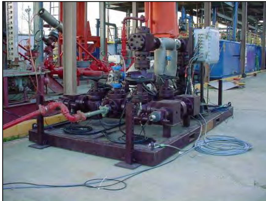
Figura 2.52 El múltiple de estrangulamiento con medidor de flujo para Perforación Segura en operación.
