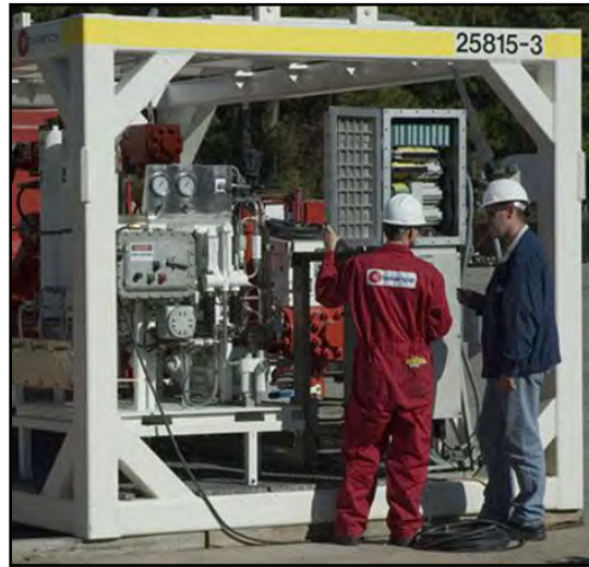
Figura 2.12 Imagen que muestra la inspección del programador lógico programable montado en el múltiple de estrangulamiento del sistema DAPC. El programador contiene tecnología de control de seguridad crítica para manejar la operación del múltiple.
