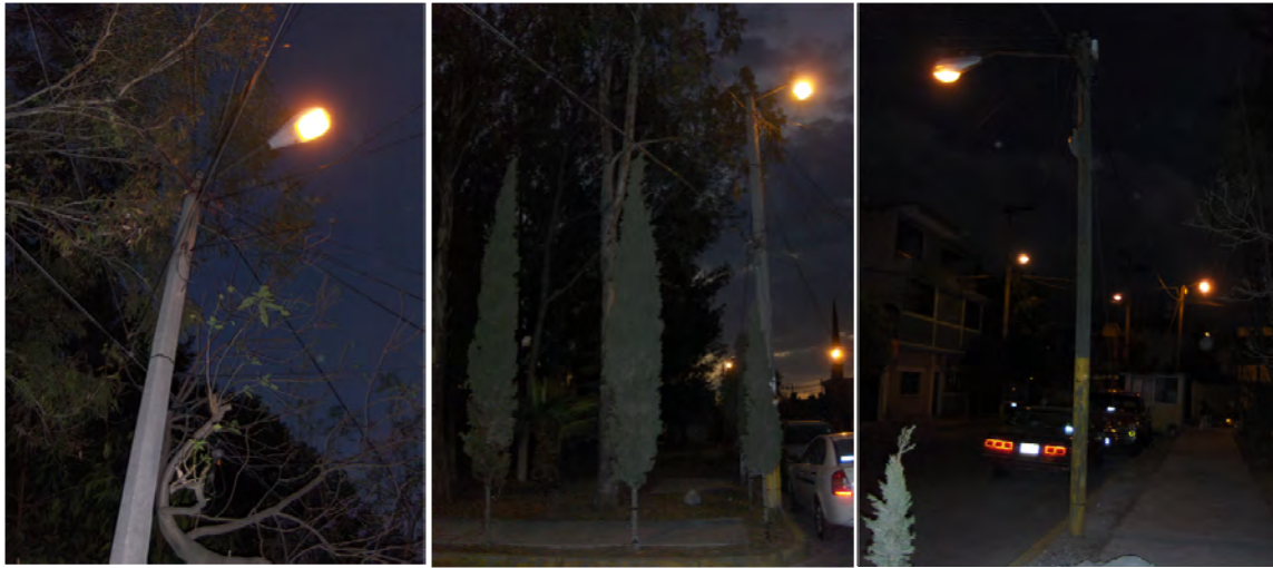
Figura 20. Imágenes de la Iluminación eléctrica del AVVF.
