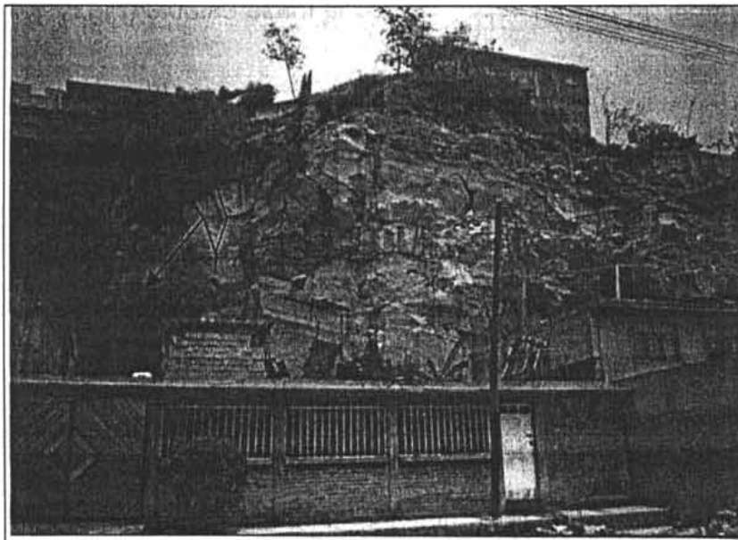
Fig. IV.3.2 En la fotografía se indican los bloques que pueden presentar caída por desprendimiento y afectar las viviendas.
