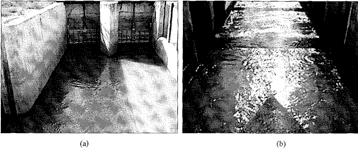
Figura 6.5. Aspecto interior del tanque de cambio de régimen (ICR) Vista hacia aguas abajo (a) y vista hacia aguas arriba (b).
