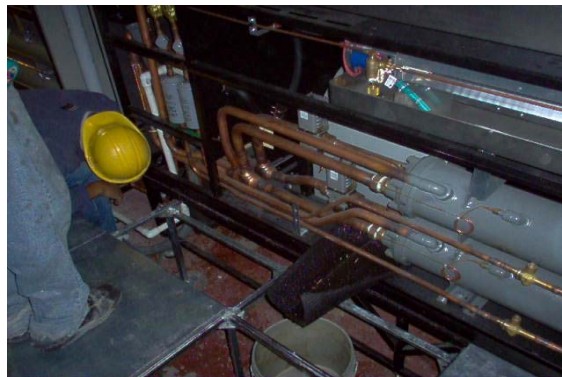
Equipo de precisión se observa el sistema de enfriamiento por agua
