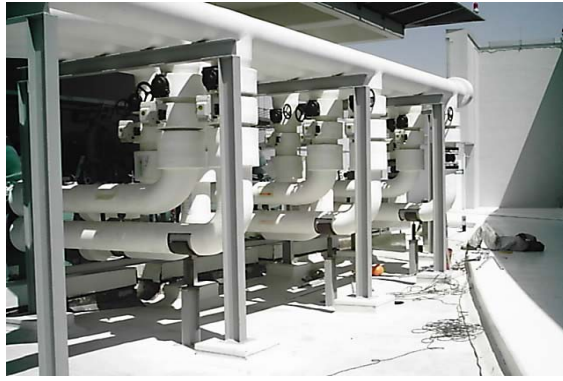
Cuadro de equipos schillers y sus respectivas instalaciones de tubería de agua helada para abastecer al edificio.
