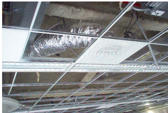
Manguera sujeta con un fleje para conservar la forma adecuada de inyección de aire al difusor.
