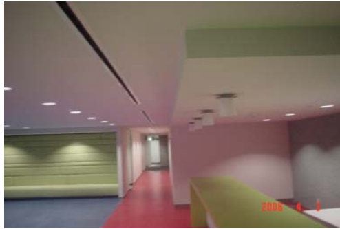
Difusores lineales instalados
