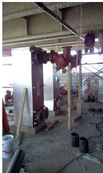
Intercambiadores para cuarto de maquinas.
