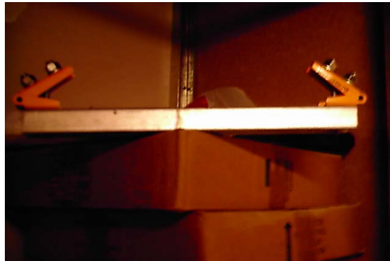
Ganchos antisísmicos para ductos de aire acondicionado.
