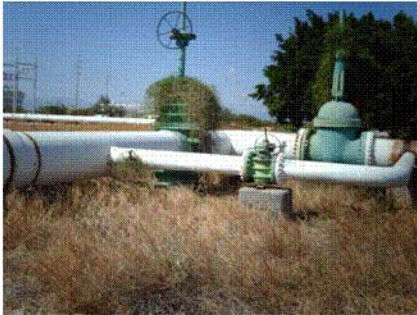
Figura. 2.7. Llegada de agua cruda a Refinería.
