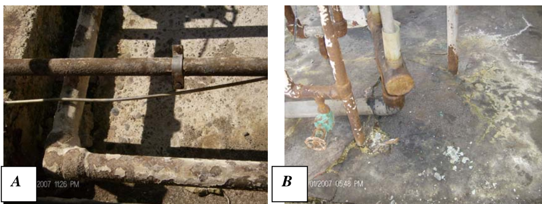
Figura 24. Daños a tubería y cimientos del área de dosificación
