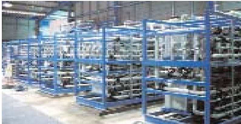
Figura 7. Equipos modulares de electrodesionización en continuo para producción de agua desionizada para calderas de alta presión (producción 2,850 \text{ m}^3/\text{día} )
