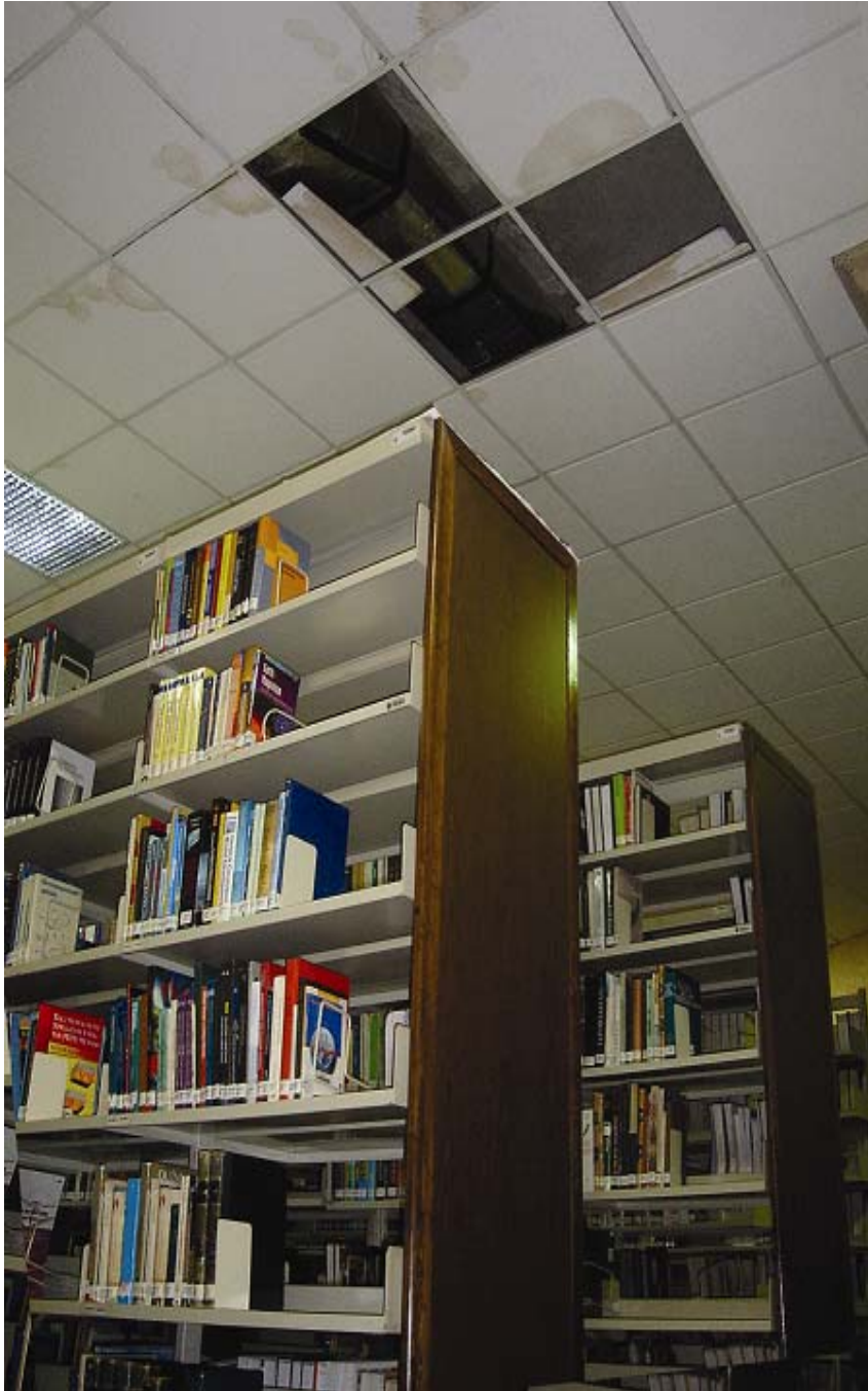
Figura 12. Filtración de agua sobre la colección general
