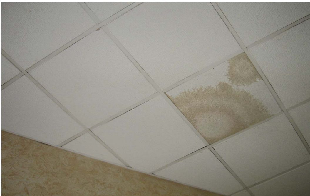
Figura 11. Techo deteriorado por lluvia
