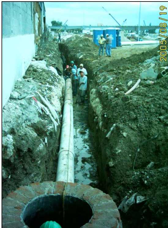
En la foto de la izquierda se observa la colocación de tubería de desalajo pluvial en uno de los Edificios, mientras que en la foto de la derecha se muestra parte de la red de drenaje sanitario exterior.
