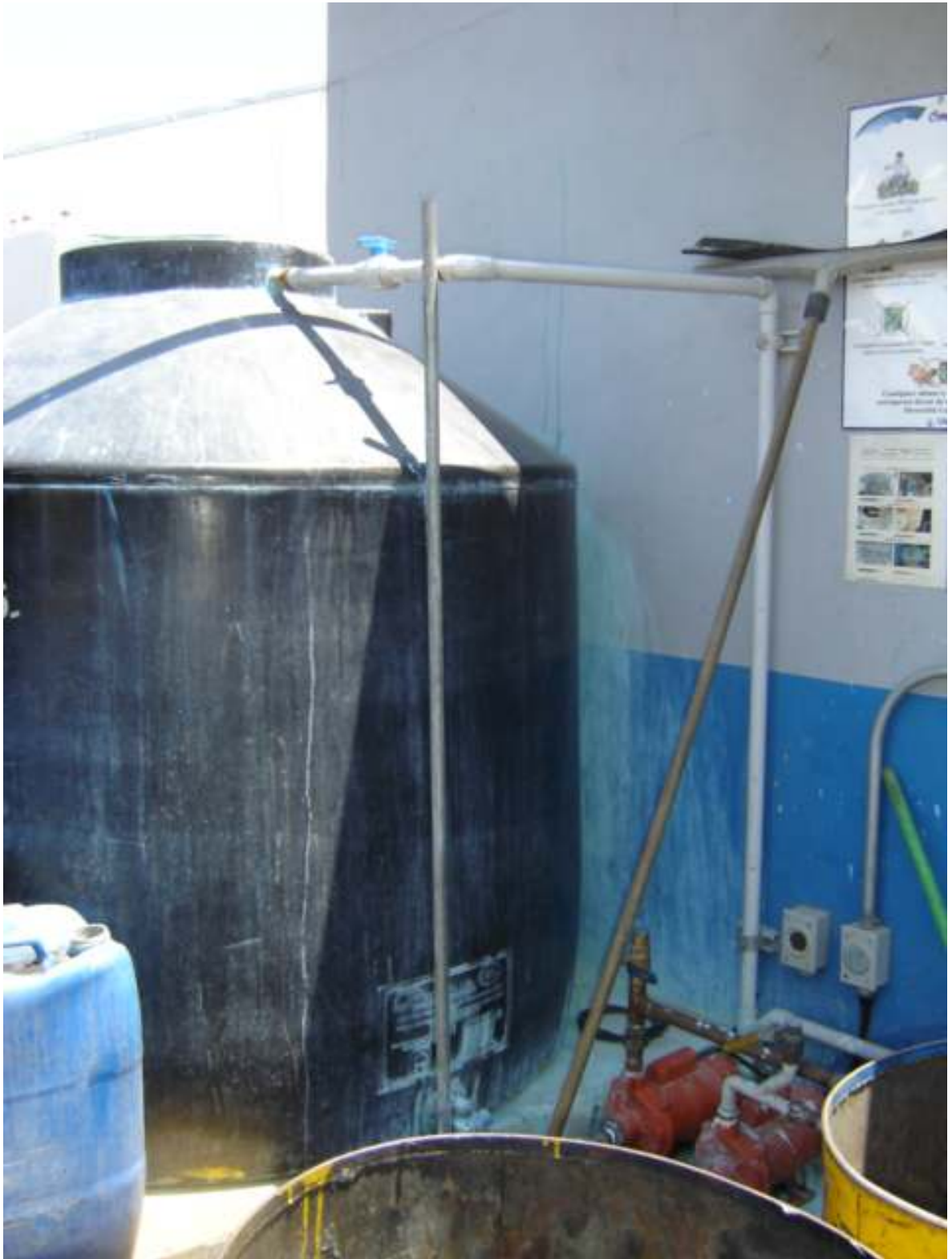
Foto 14. Tanque donde el cliente prepara la mezcla agua – sanitizante.
