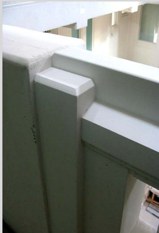
Detalle de barandal, con terminado final y pasamanos adicional para alcanzar la altura reglamentaria.
