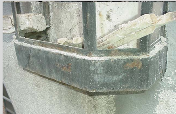
Deterioro de lámpara
