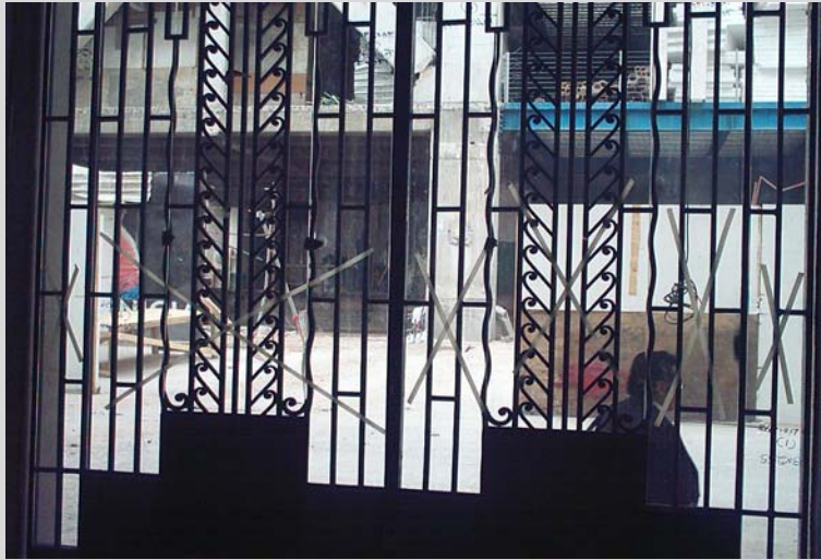
Estado original de la puerta exterior de la calle de Independencia
