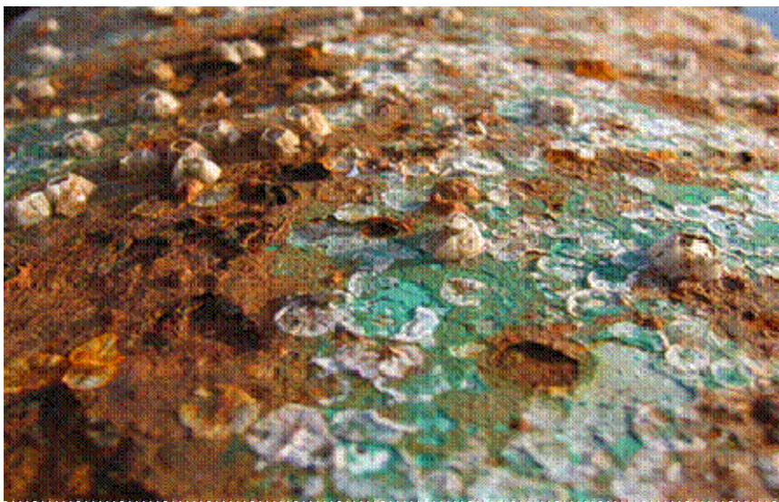
Figura 7. Oxidación del metal
