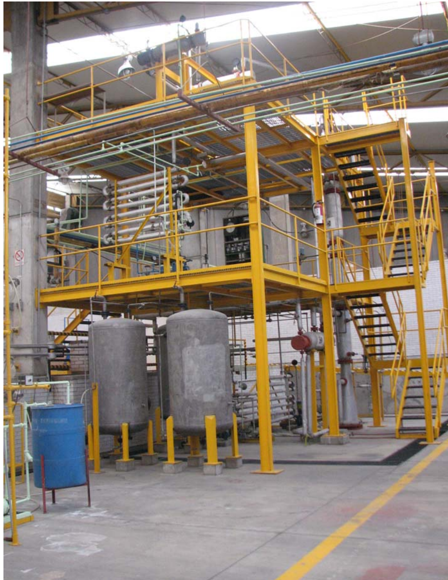
Foto 9: Torre de destilación.
