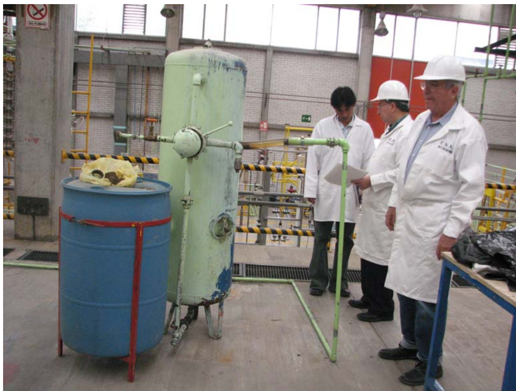
Foto 1: recorrido de ubicación y reconocimiento de equipos.
