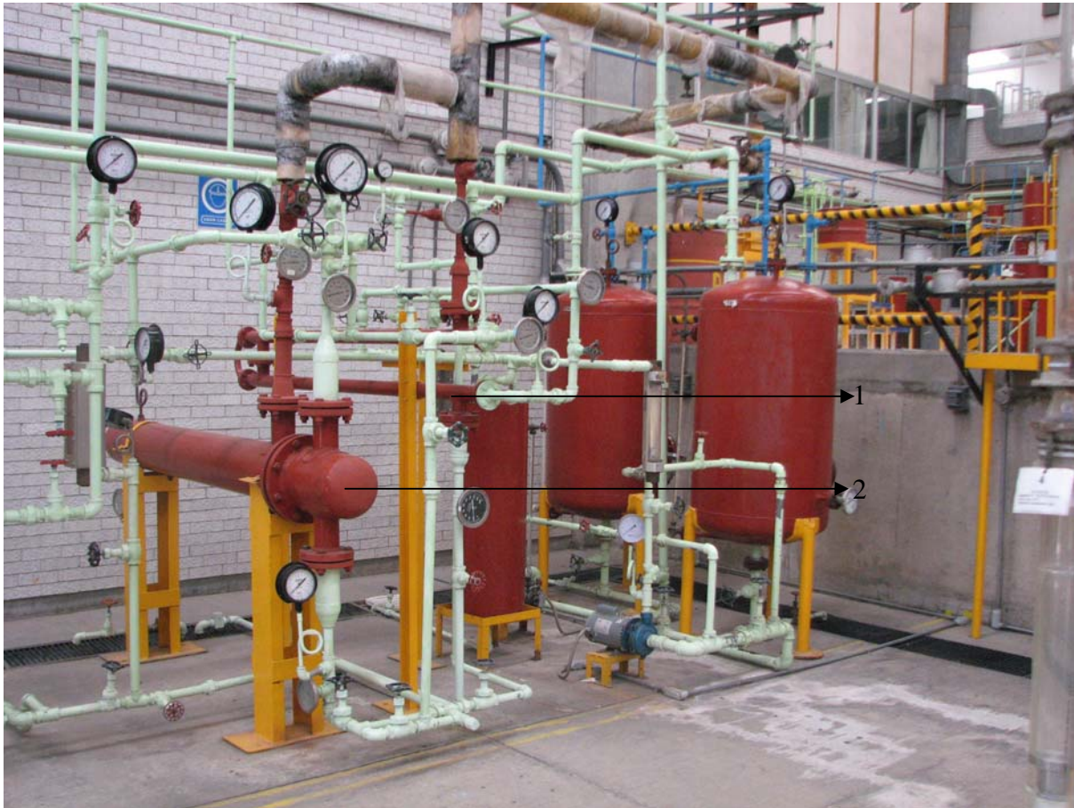
Foto 5: Intercambiadores de calor metálicos (1 tubos concéntricos, 2 tubos y coraza)
