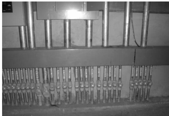
Figura 7.1.2 Tableros y control en cuarto eléctrico
