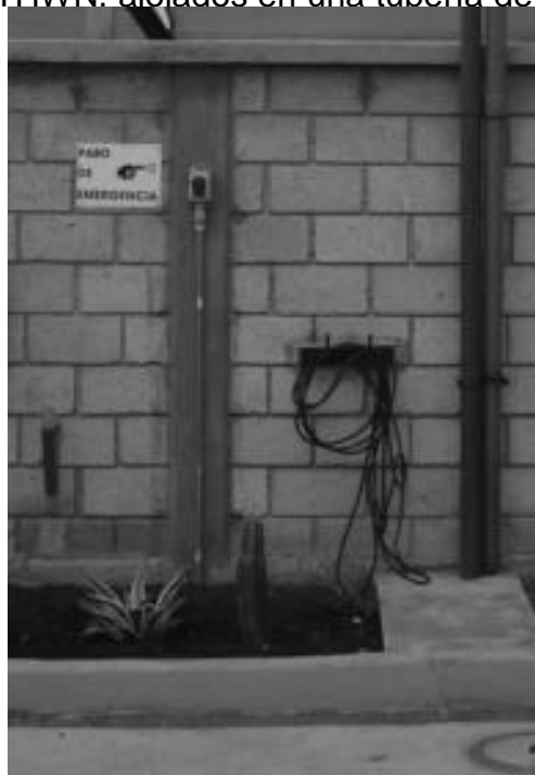
Figura 7.5.1 Paro de emergencia en zona de tanques
