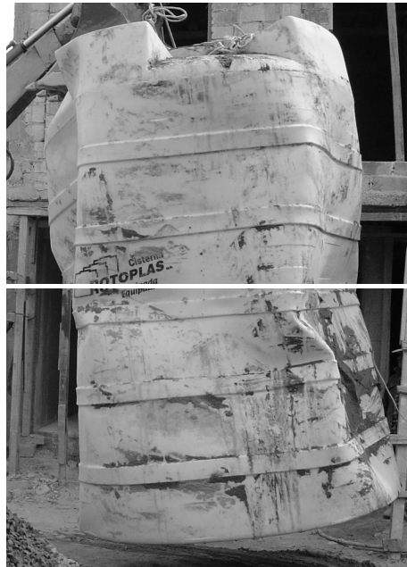
Figura 5.2.2 Esta cisterna se instaló sin hacer caso al llenado de agua antes de iniciar el relleno de la fosa
