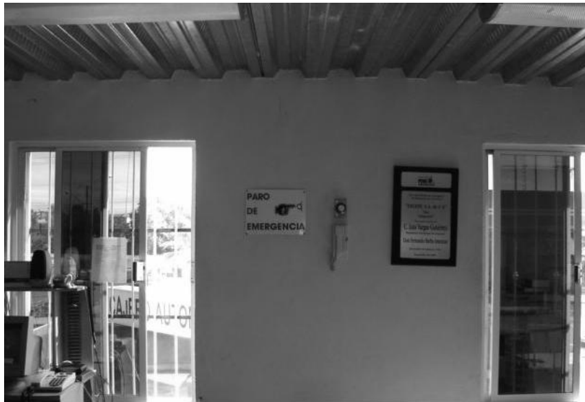
Figura 7.1.1 Botón de paro de emergencia y luminarios en la oficina
