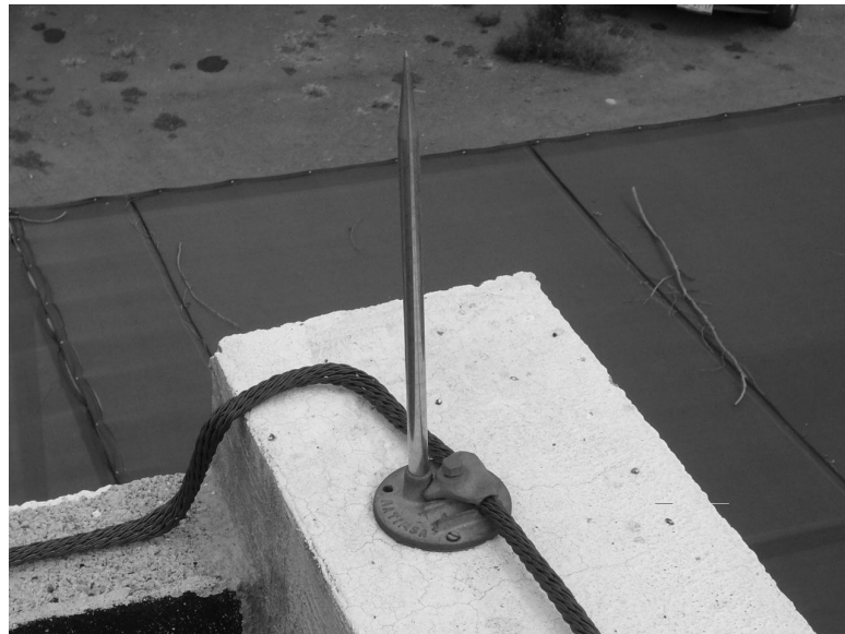
Figura 7.8.4 Varilla para sistema de pararrayos
