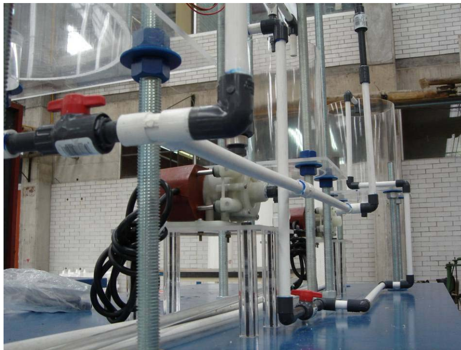
Figura.39. Bombas con tubería instalada.
