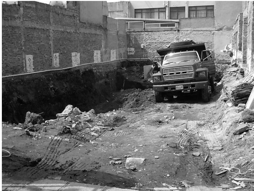
Conforme se realizaba la excavación se procedía al retiro del material producto de la misma
