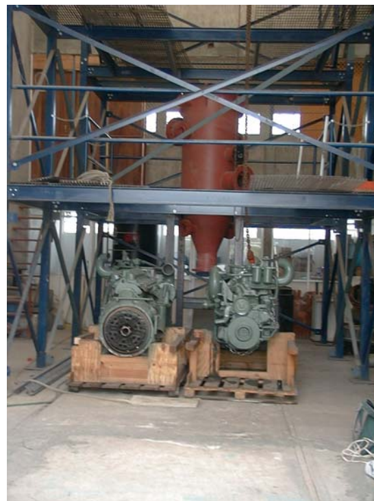
Figura 3.4 Vista de Gasificador y motores.
