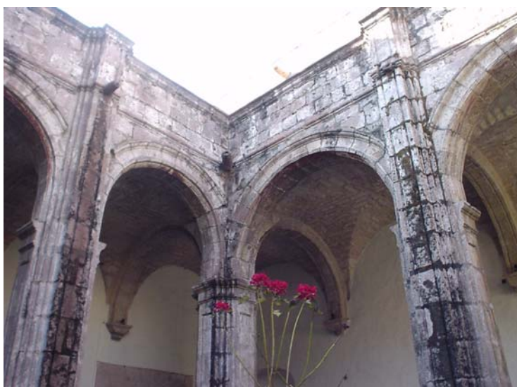
Imagen 68. Deterioro del claustro del convento
