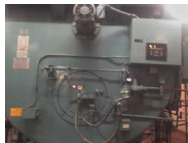
Fig.8. Tablero de control de caldera.
