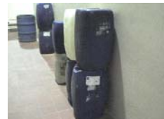
Fig.15. Perrones de condensadores.
