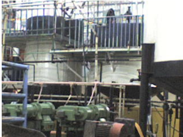
Fig.5. Pailas de almacenamiento de grasas de proceso.
