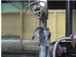
Fig.12. Válvula de línea de vapor.
