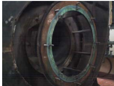
Fig.10. Interior de Caldera.
