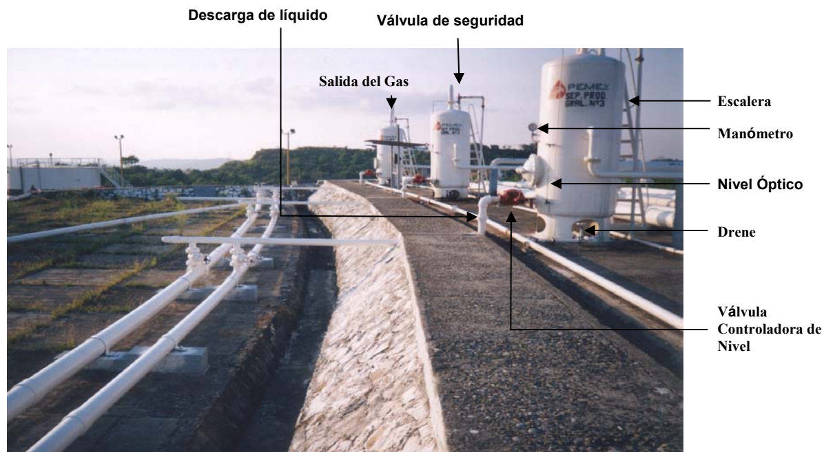
Figura A1.4 Foto de una Batería de Separación con algunos de sus componentes.
