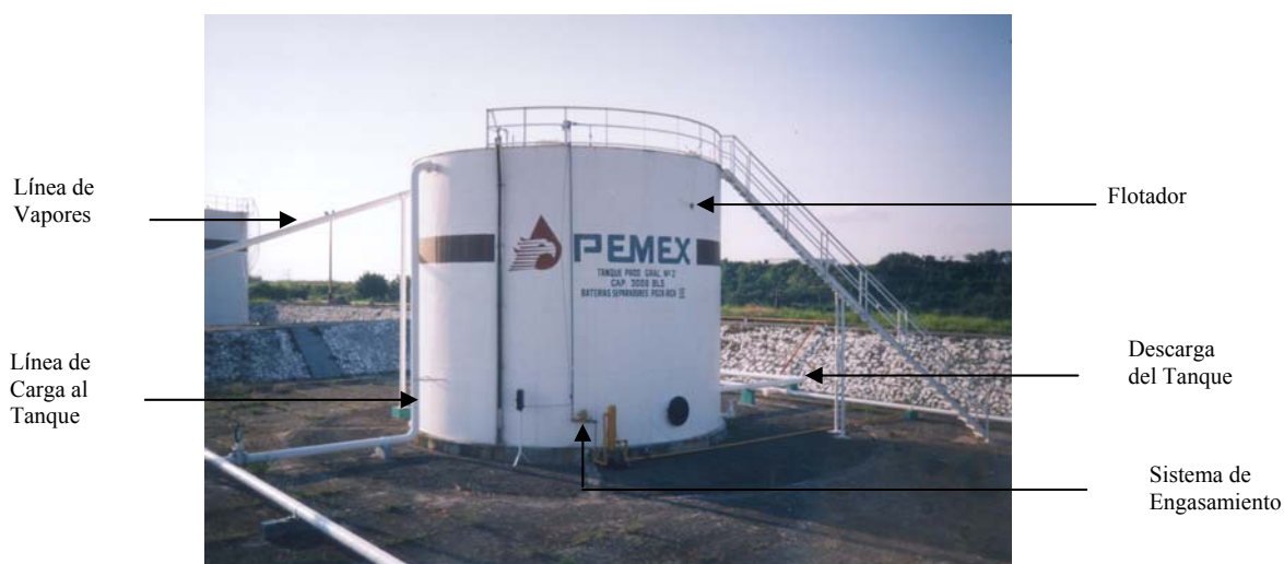
Figura A1.6 Tanque de Producción General.
