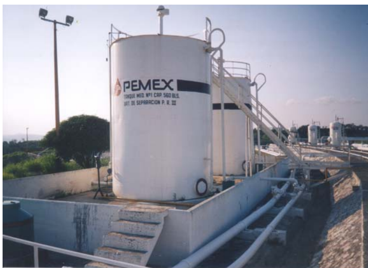
Figura A1.5 Tanque de Medición.
