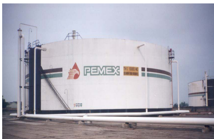
Figura A1.7 Tanque deshidratador.
